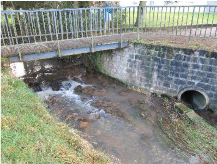
Absturz; hoher - Durchlass; nicht strukturschaedlich
