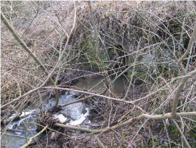
Durchlass; Lauf verengt
