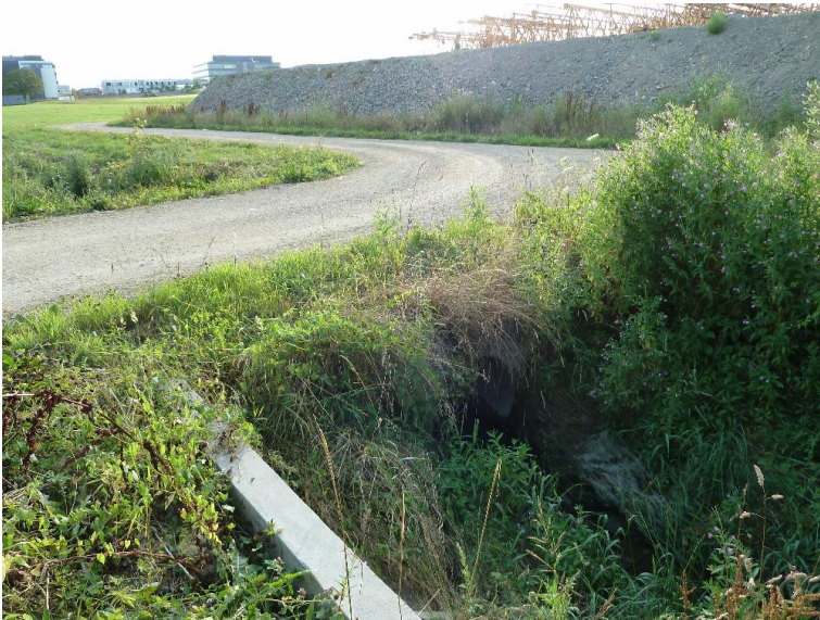
Durchlass; Lauf verengt
