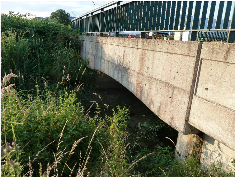
Durchlass; Ufer unterbrochen
