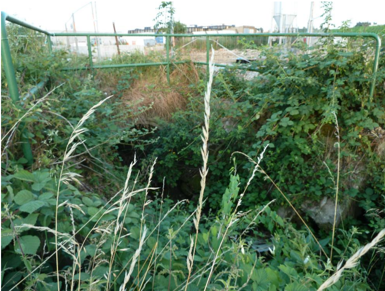
Durchlass; Lauf verengt
