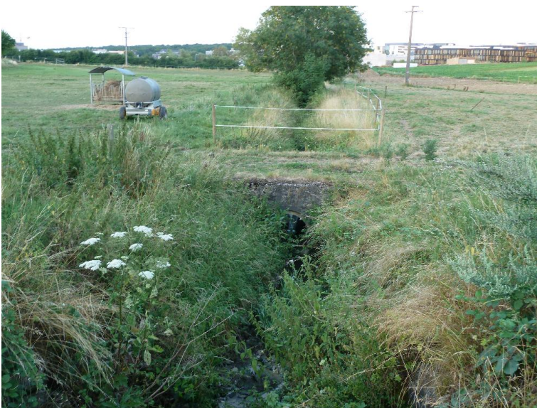
Gruenland - Durchlass; Lauf verengt
