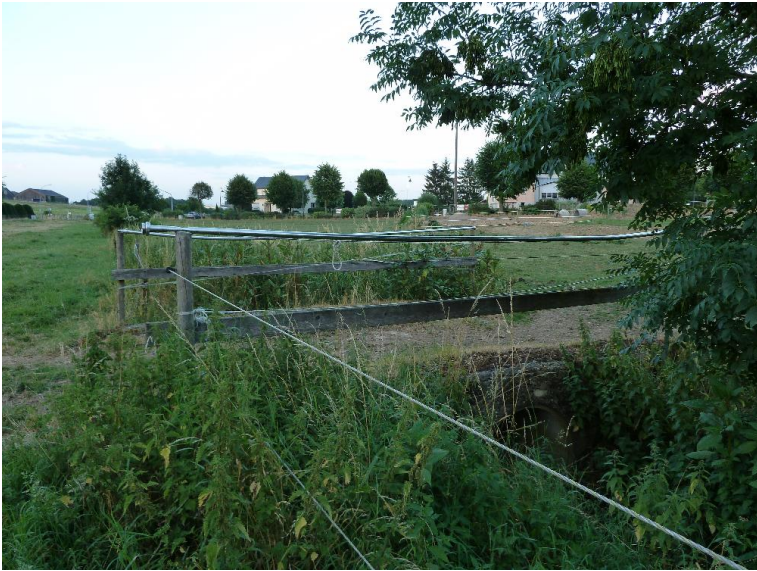
Durchlass; Lauf verengt
