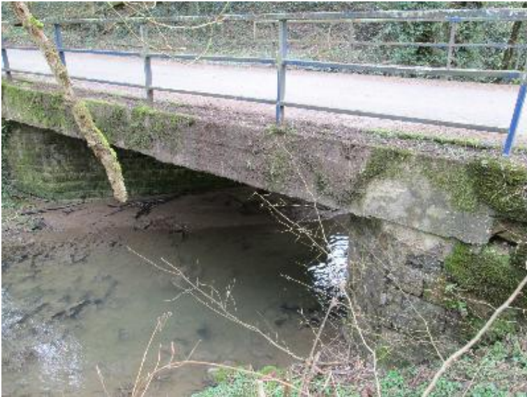
Durchlass; Ufer unterbrochen
