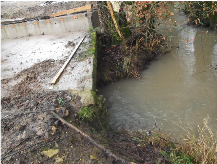
Bruecke siehe Durchlass
