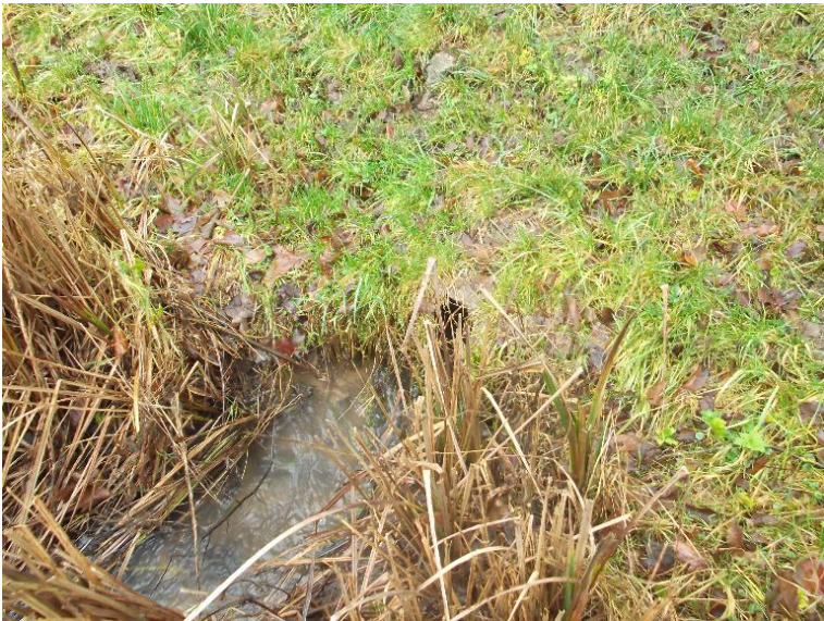
Durchlass; Lauf verengt
