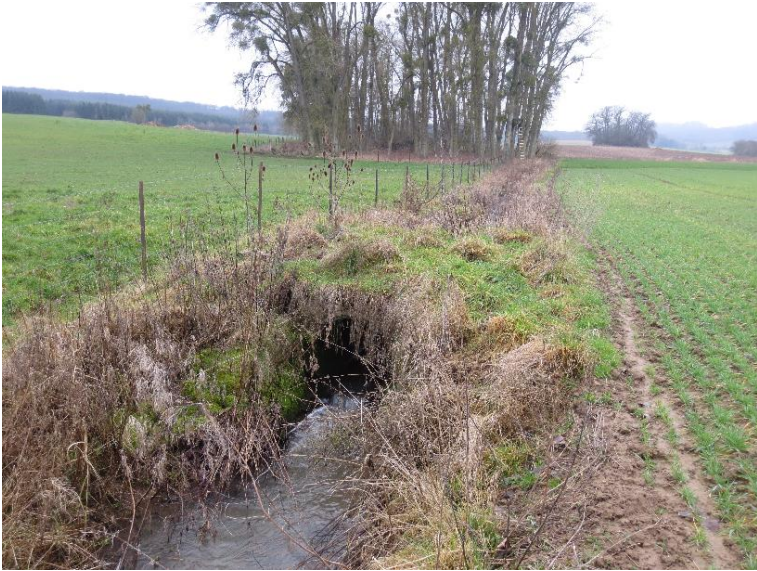
Durchlass; Lauf verengt
