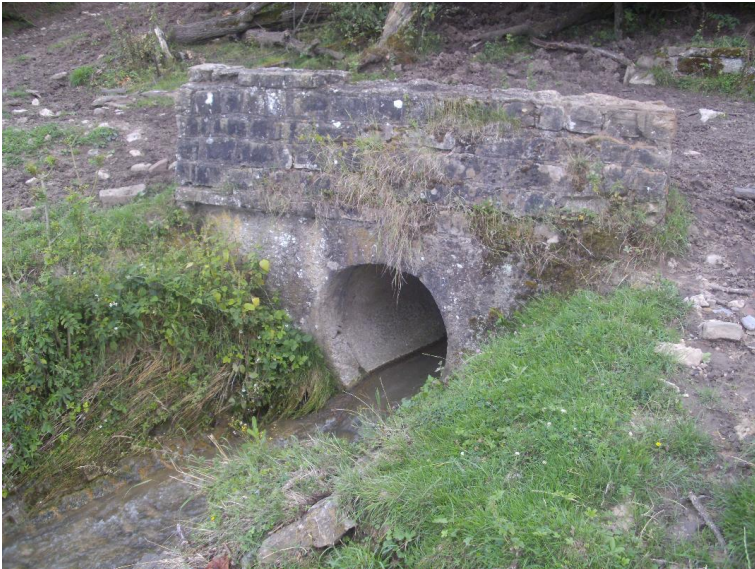
Durchlass; Ufer unterbrochen
