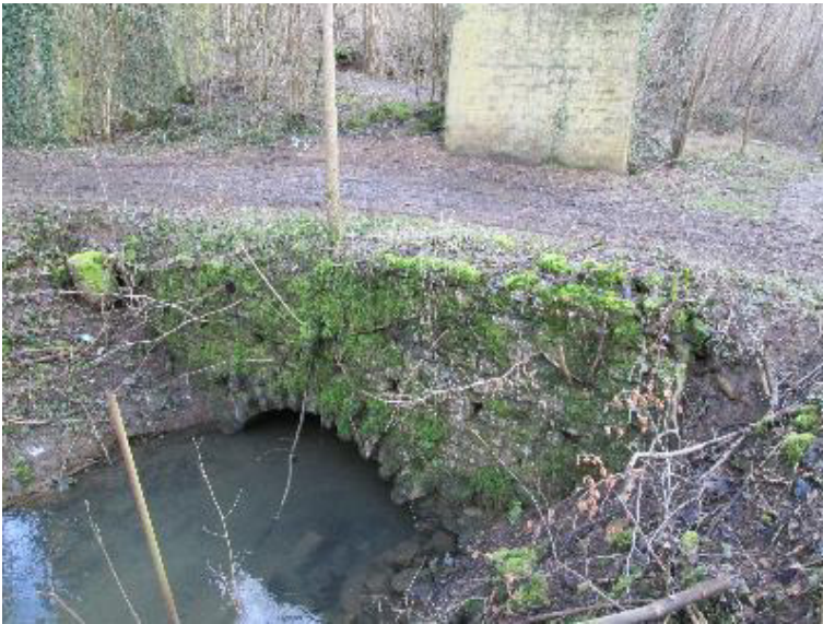
Durchlass; Lauf verengt
