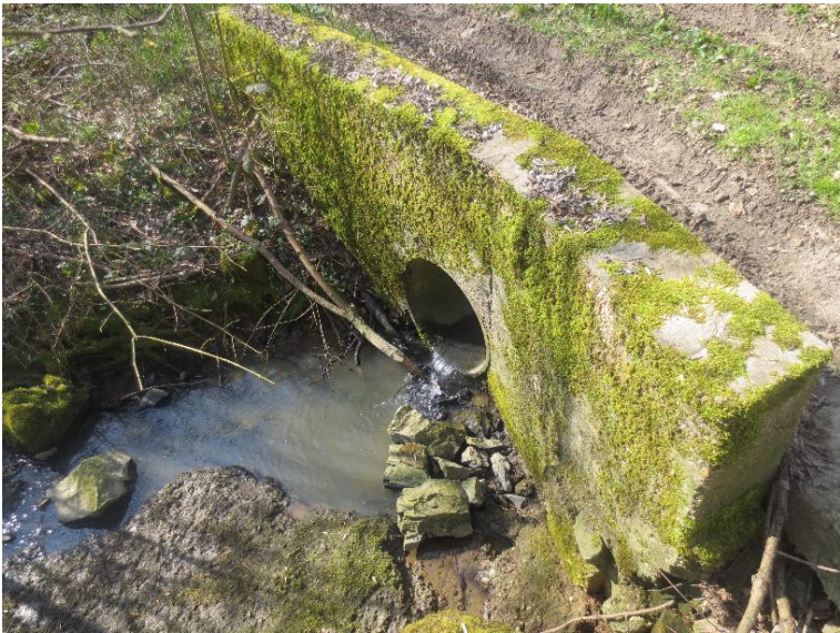
Absturz aus Verrohrung
