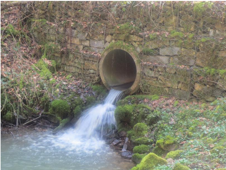
Absturz aus Verrohrung
