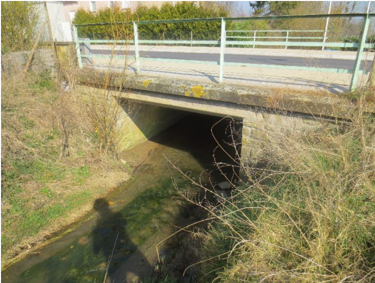
Durchlass; Ufer unterbrochen
