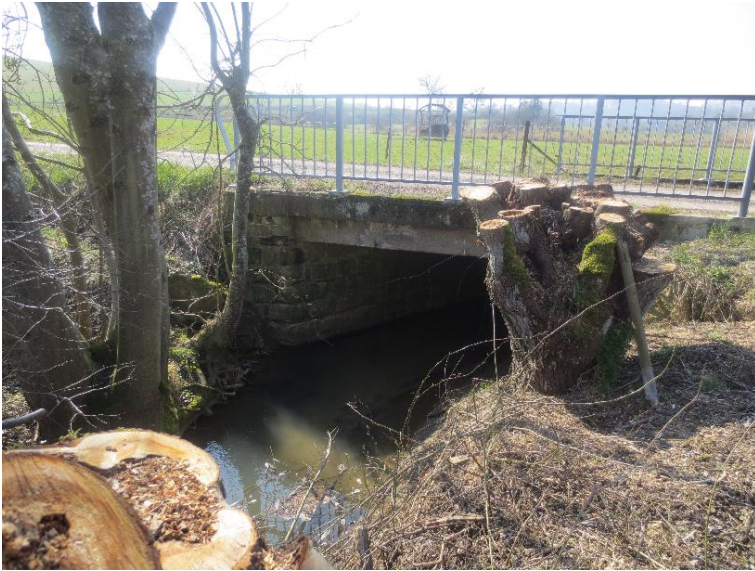
Durchlass; Ufer unterbrochen
