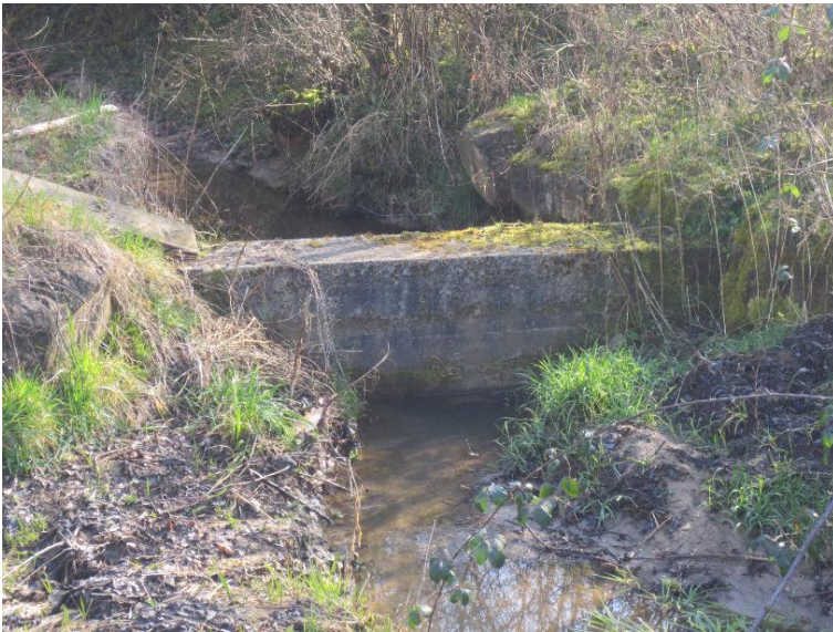
Durchlass; Lauf verengt
