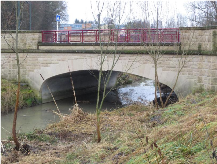
Durchlass; Ufer unterbrochen
