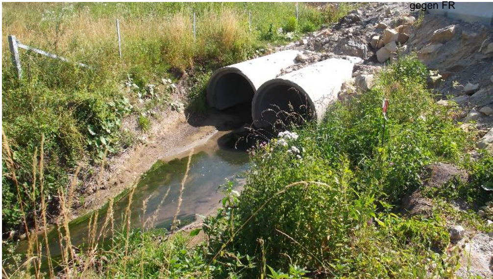
Durchlass; Lauf verengt
