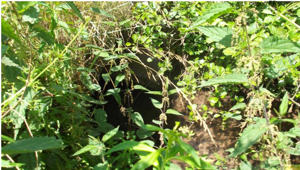
Durchlass; Lauf verengt
