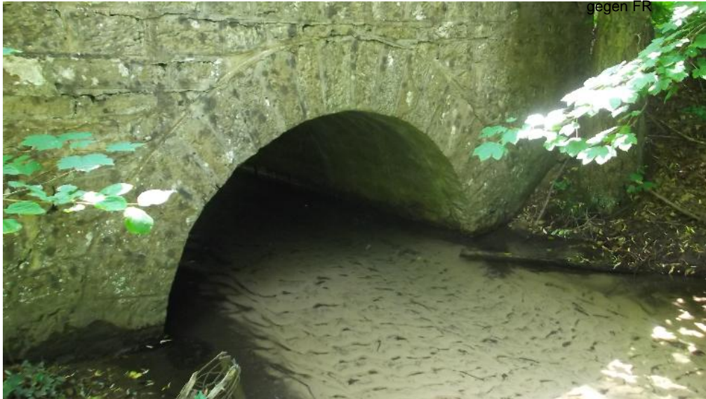
Durchlass; Lauf verengt
