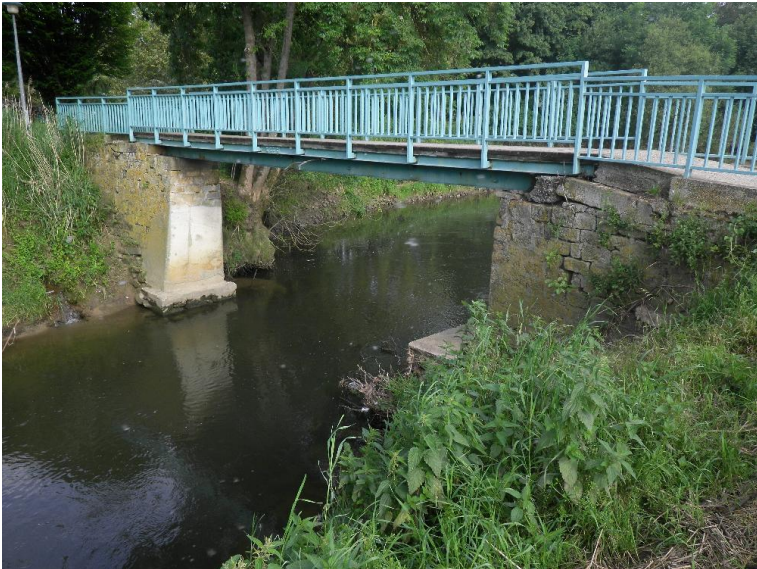
Durchlass; Lauf verengt
