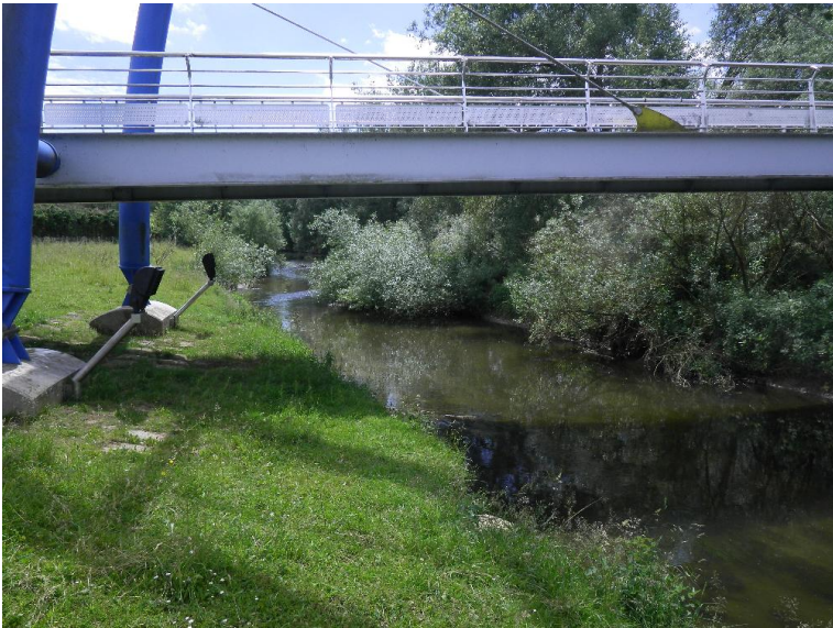
Durchlass; nicht strukturschädlich
