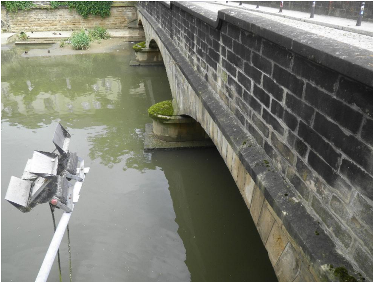
Durchlass; Lauf verengt
