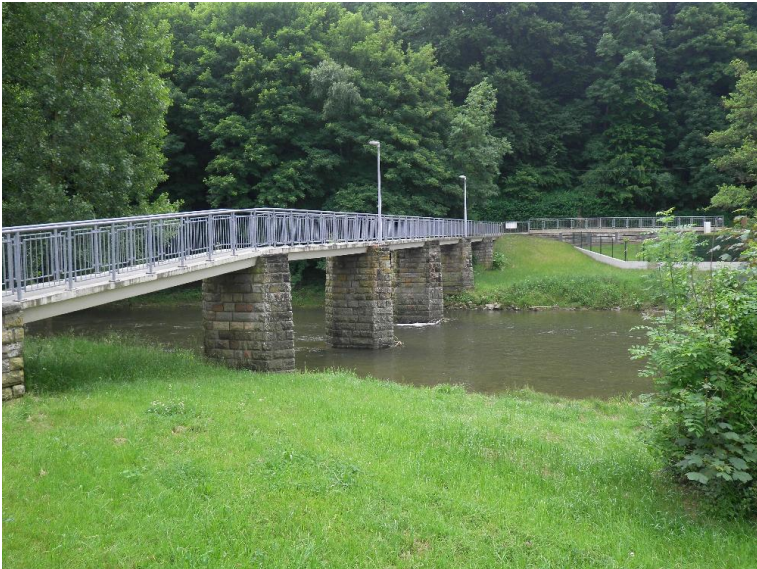
Durchlass; Lauf verengt
